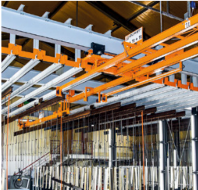
Der Lohnbeschichter kann jetzt Werkstücke von 8 m Länge, 2,5 m Breite, 2,8 m Höhe und einem Gesamtgewicht von 1000 kg bzw. 2000 kg mittels Tandemgehänge beschichten.
